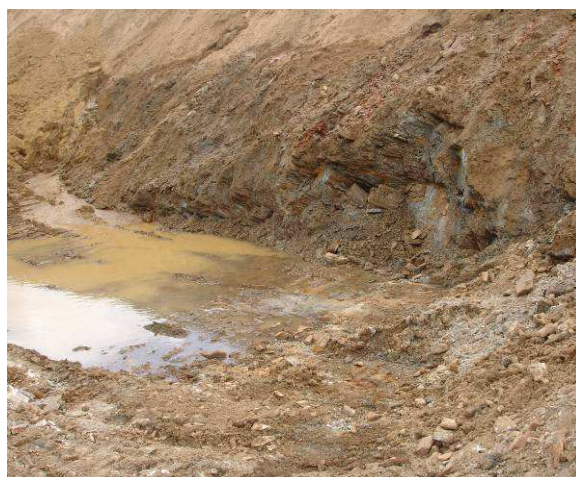
FOTO 78 – PRESENÇA DE ROCHA ALTERADA NA FUNDAÇÃO DO MACIÇO PRINCIPAL.
