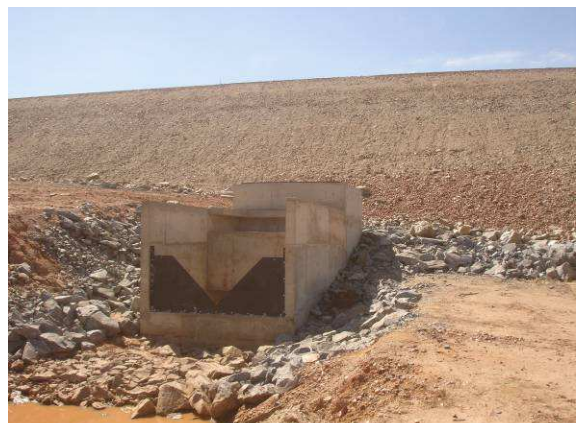
FOTO 104 – CAIXA DE JUSANTE COM MEDIDOR DE VAZÃO TRINAGULAR EM CHAPA DE AÇO
