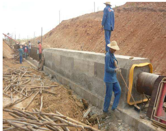
FOTO 94 – TOMADA D'ÁGUA – VISTA PARCIAL DE TRECHO DESFORMADO E JUNTA DE DILATAÇÃO TIPO FUNGEBAND
