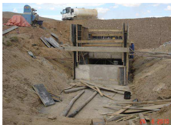
FOTO 102 – TOMADA D'ÁGUA – DESFORMA DA CAIXA DE JUSANTE.
