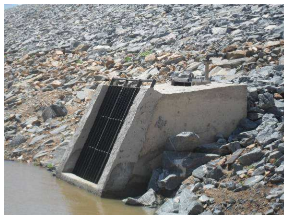
FOTO 108 – TOMADA D'ÁGUA – CAIXA DE MONTANTE.
