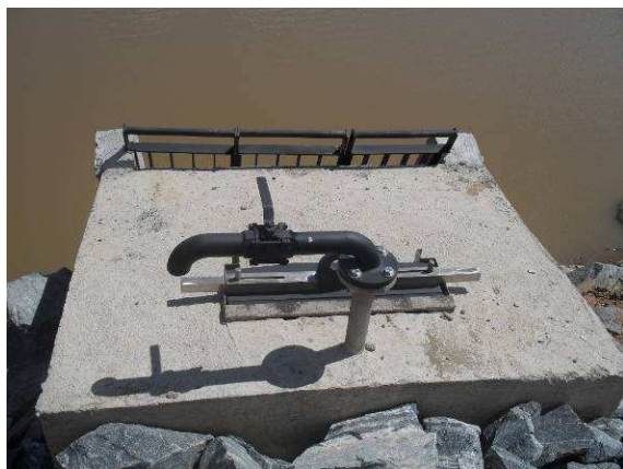
FOTO 109 – LAJE SUPERIOR DA CAIXA DE MONTANTE.
