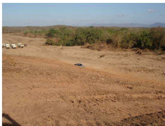
FOTO 10 – DESMATAMENTO NA OMBREIRA ESQUERDA.
